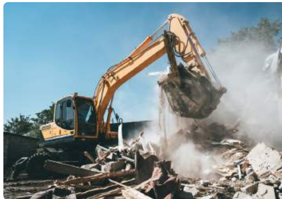
Las casas han sido demolidas.
